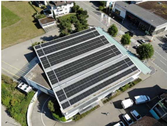
Beispiel Photovoltaik-Anlage Reiden
